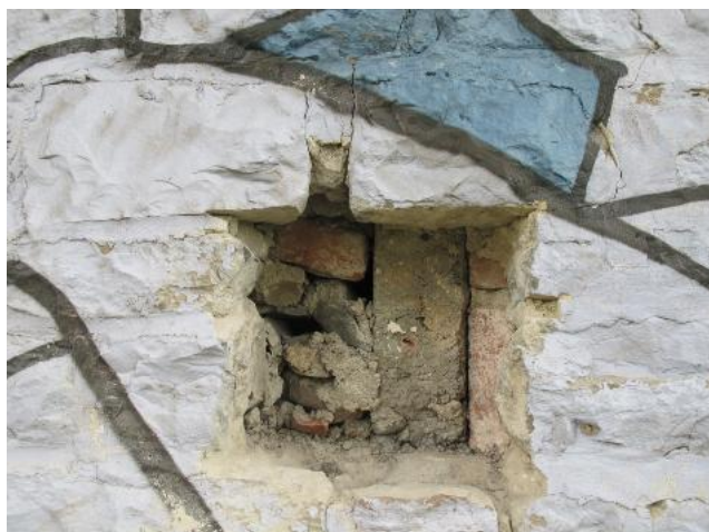
O.E. no. 17, présence de briques, 22 mai 2019
