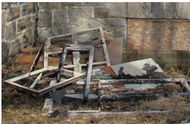
Vestiges des fenêtres, 2014
