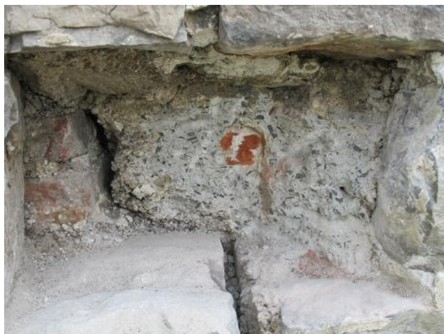
O.E. no. 11, présence de briques, 22 mai 2019
