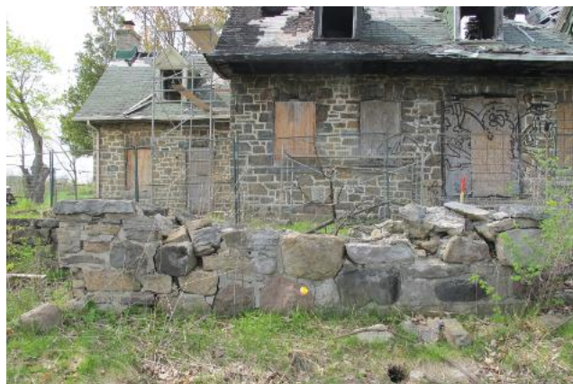
Effondrement d'une partie du muret
