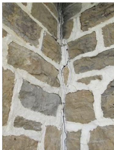
Réparations antérieures de lézardes
