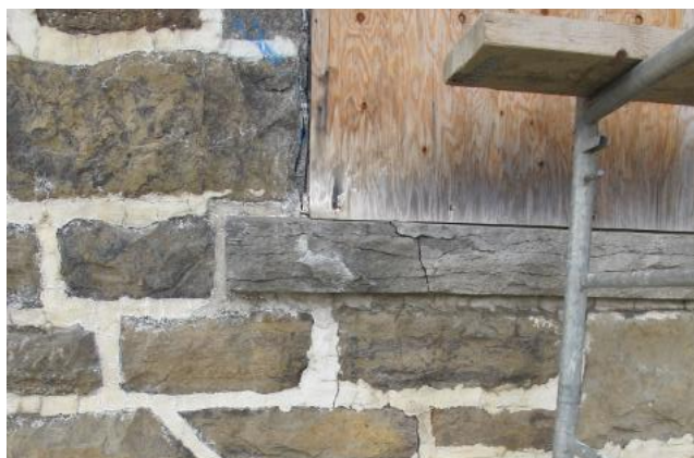
Allège no. 10, fissure et délamination
