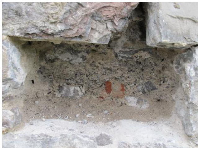
O.E. no. 9, présence de briques, 22 mai 2019
